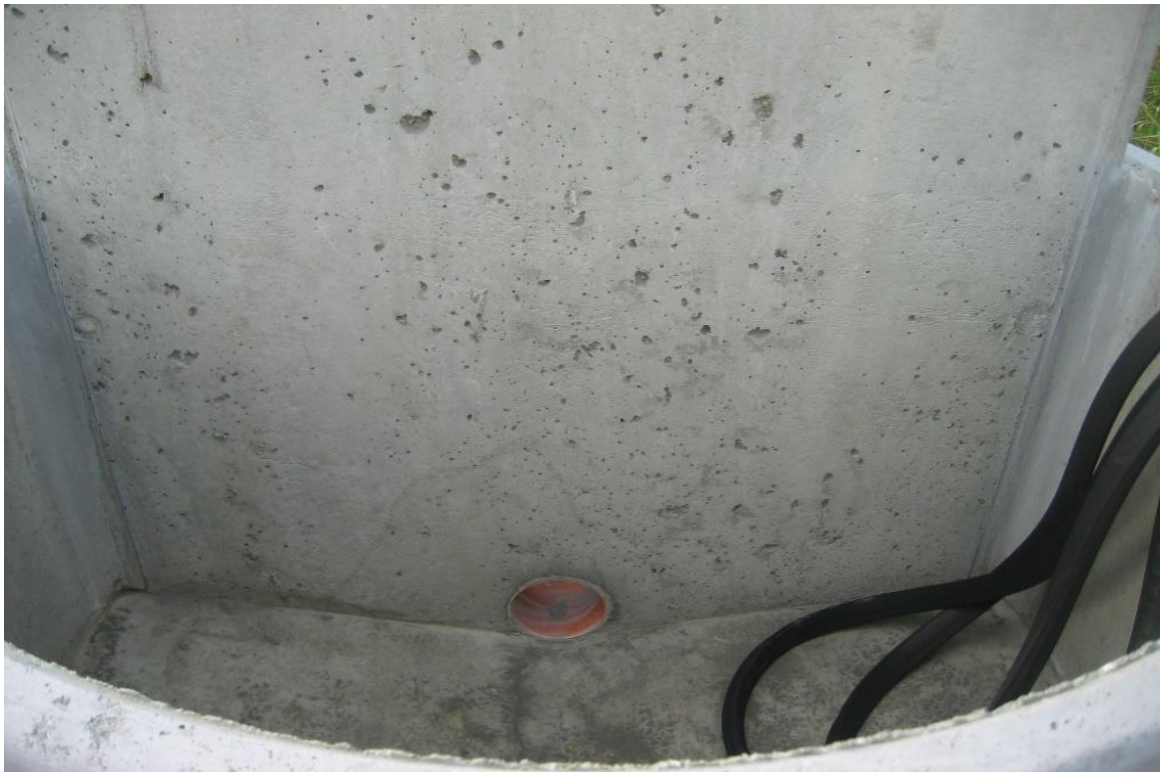
Bild 2: Rohrdrossel in der Stauwandim Sohl- bzw. Gerinnebereich
